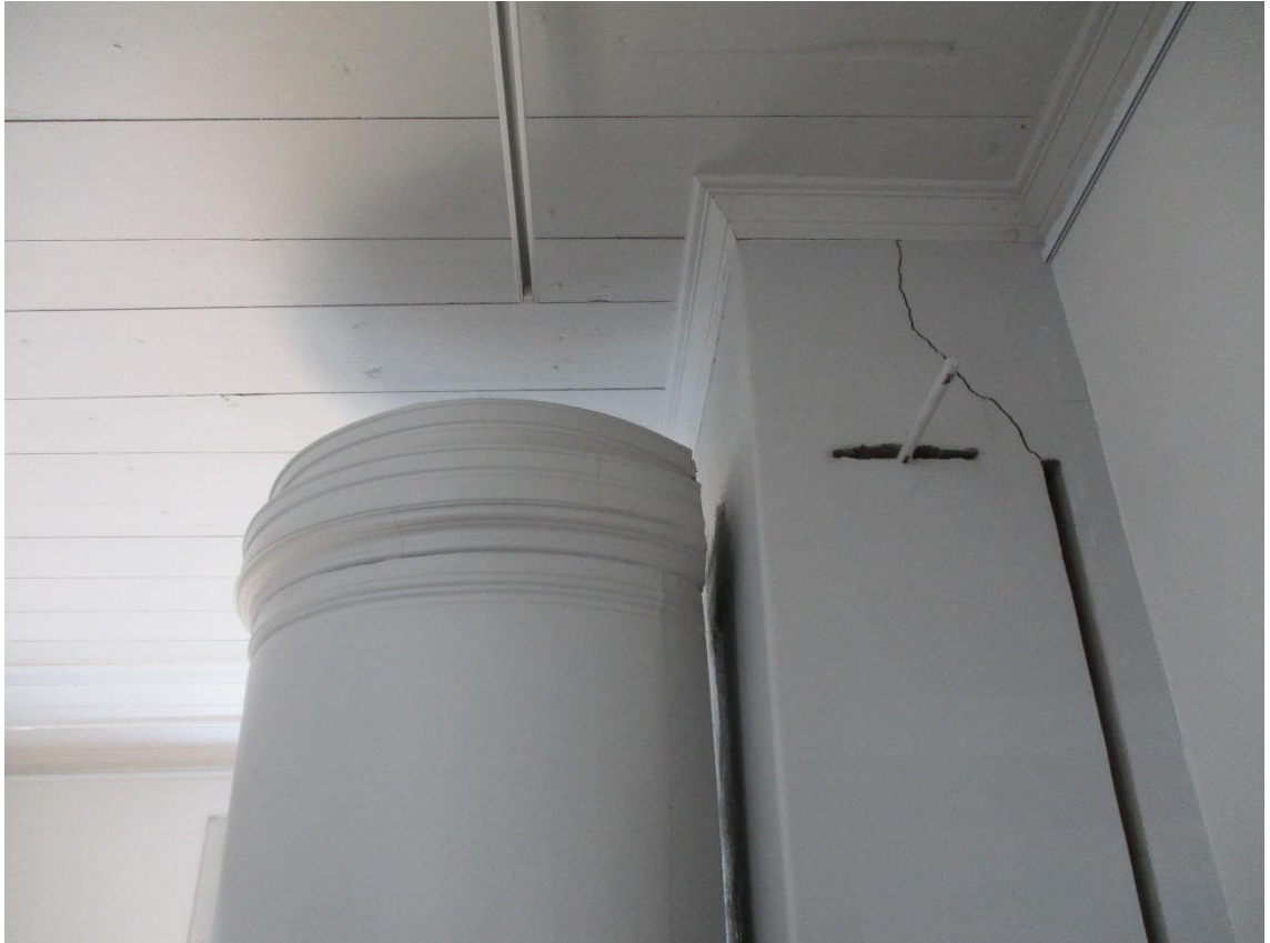
Kuva 40 Tulisijan ja savupiipun alla oleva perustus on rikkoutunut, jolloin peltikuorinen pönttöuuni on kallistunut ulospäin ja savupiippu on hajennut.
