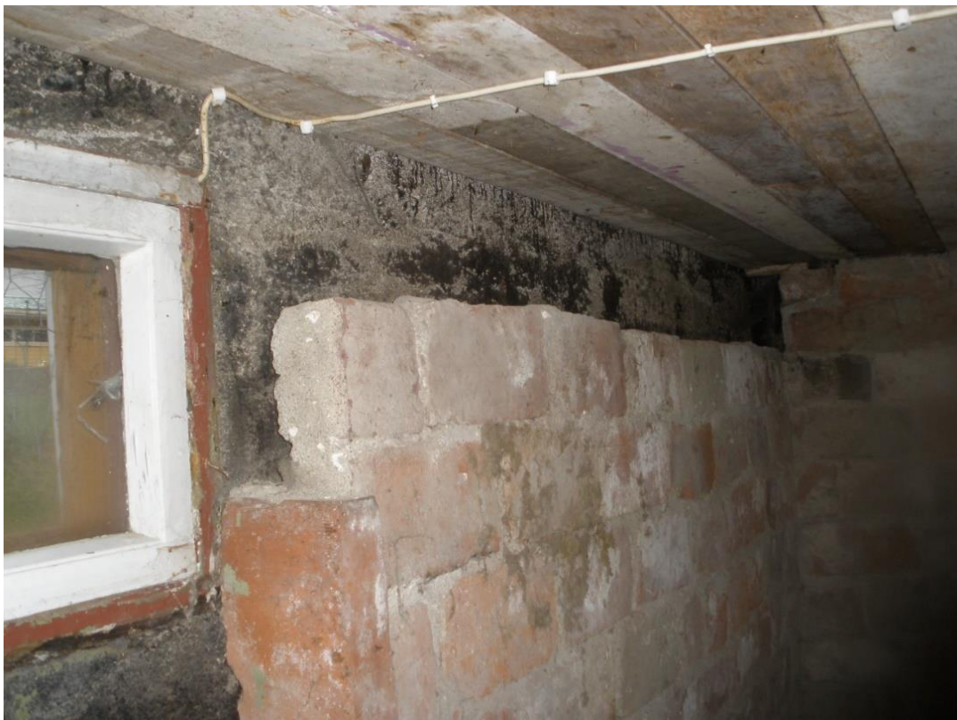
Kuva 5 Rivintearauksen eli verhomuurauksen takana on perusmuurin sisäpinnassa kreosoottipitoinen pikisively.
