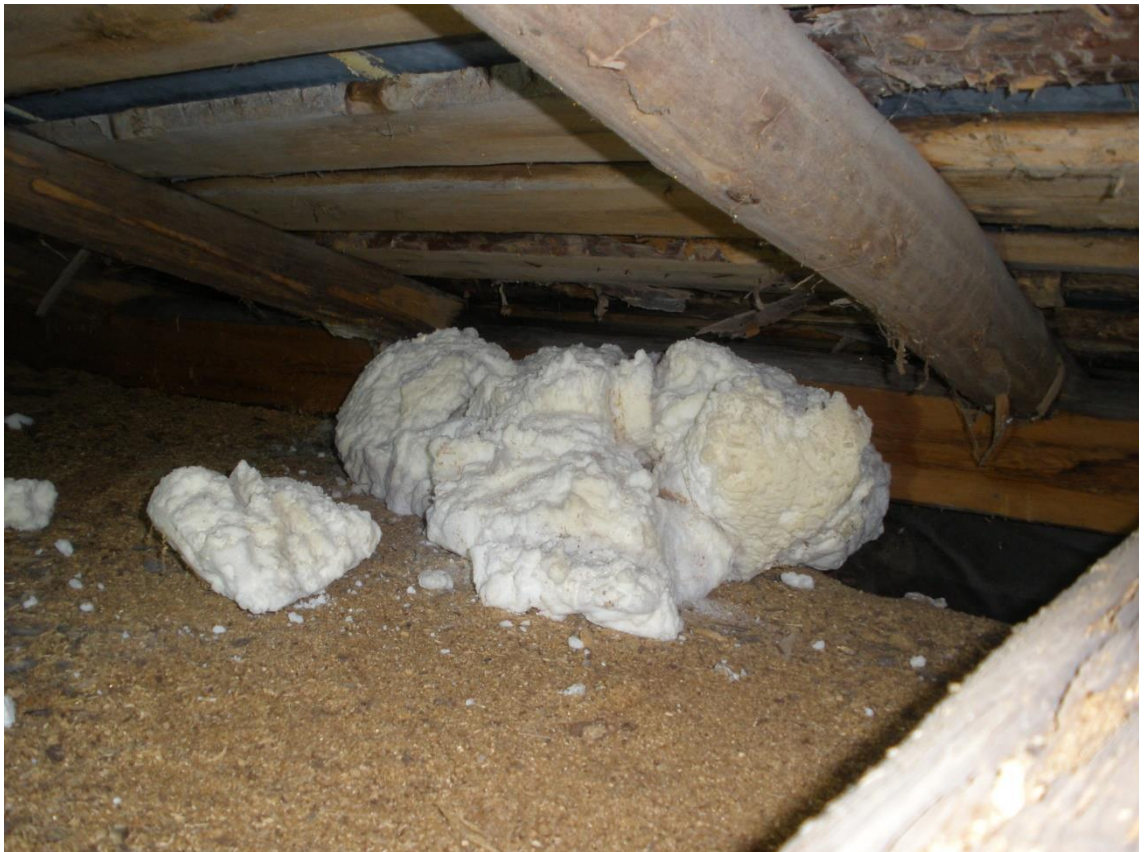
Kuva 12 Seinärakenteeseen kovalla paineella ruiskutettu ureavaahto on päätenyt rintamamiestalon vintille, jossa se on pysynyt muuttumattomassa muodossa useita vuosikymmeniä.
