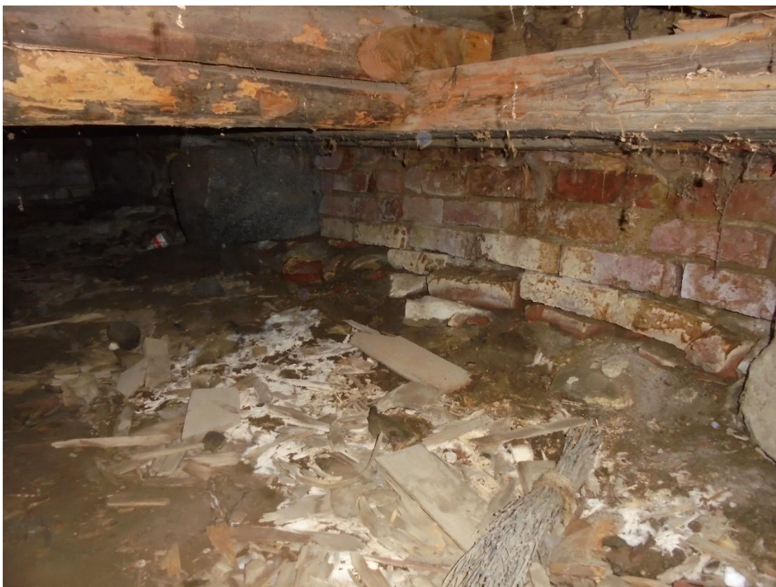
Kuva 53 Hienojakoinen maaperä nostaa kosteutta ryömintätilaan. Alapohjarakenteiden lisäksi myös ryömintätilan pohjalla oleva orgaaninen materiaali on vaurioitunut.
