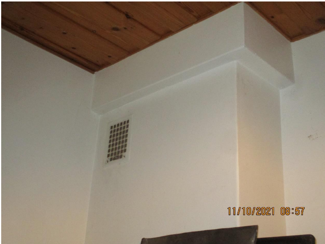
Kuva 69 Säleventtiili johtaa savupiipun poistoilmahormiin.
