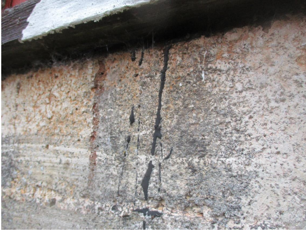
Kuva 6 Perusmuurin päällä on kapillaarikatkokerroksena kreosoottipitoista pikisivelyä, joka näkyy perusmuurin pinnassa mustina valumajälkinä.
