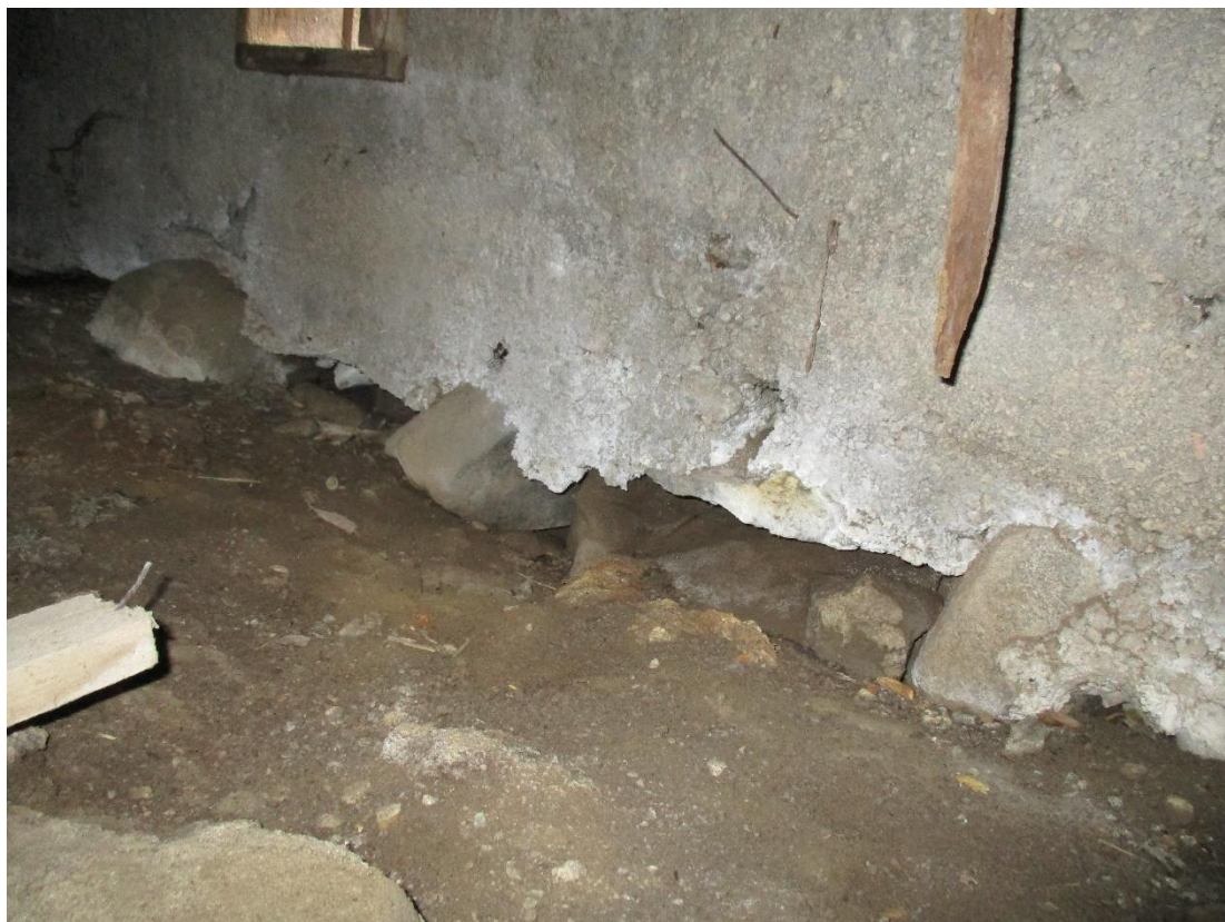
Kuva 18 Perusmuurin alla olevaa kivilatomusta ei ole tarkoitettu kapillaarikatkoksi. Kivi katkaisee kapillaarisen kosteuden nousun alhaalta päin, mutta kosteutta pääsee siirtymään perusmuurirakenteeseen sivusuunnassa ulkopuolista maatyttöä pitkin.
