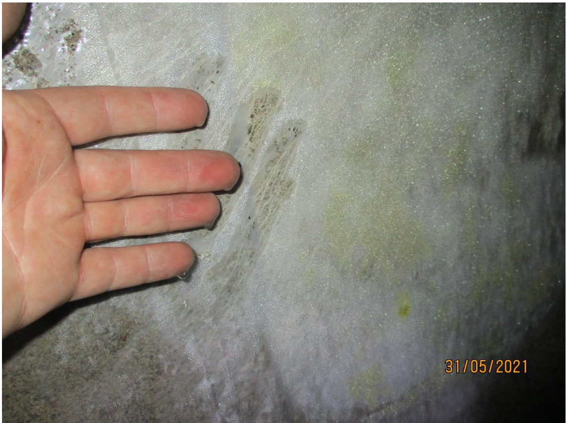
Kuva 47 Kostean kellarin seinässä kasvavan sienikasvuston pintaan on tiivistynyt ilmankosteutta.
