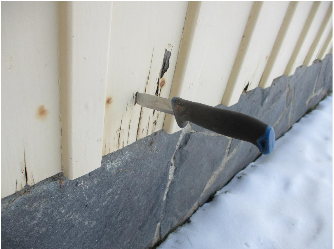
Kuva 56 Etenkin pystysuuntaisen ulkuvuoren alahelmassa tapahtuu vaurioitumista.
