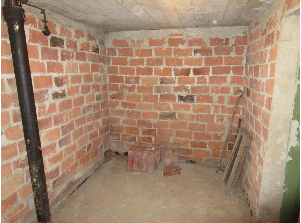
Kuva 44 Syrjätiilimuurauksena toteutettu rivintearaus. Tässä kohteessa rivintearauksen takana on kreosoottipitoinen pikisively.
