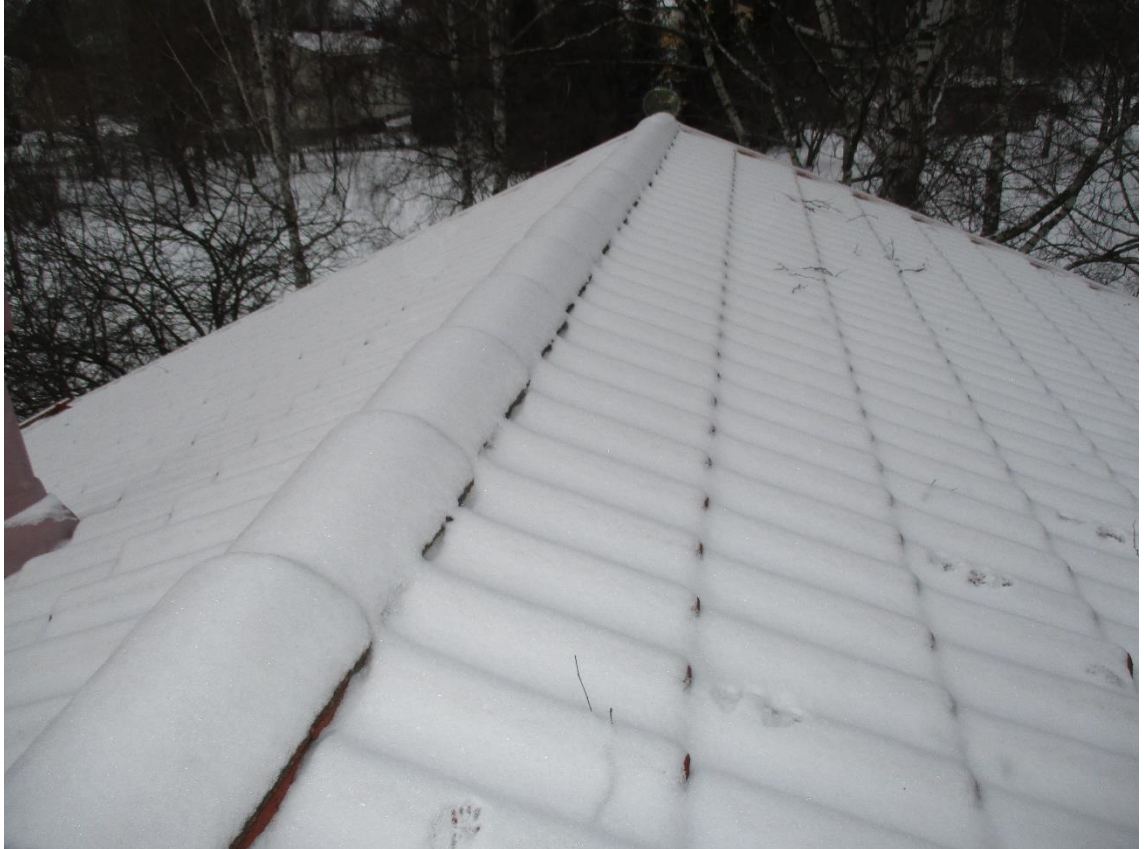
Kuva 62 Jos katolla on lunta, on katteen kuntoa arvioitava sen teknisen käyttöiän perusteella.
