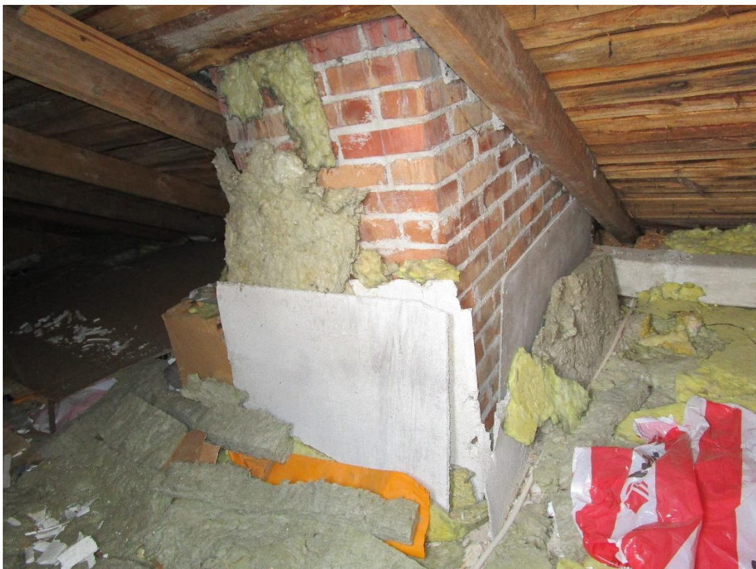
Kuva 66 Savupiippu on rappaamaton ja sen ympärillä on palovillan sijaan tavallista mineraalivillaa.
