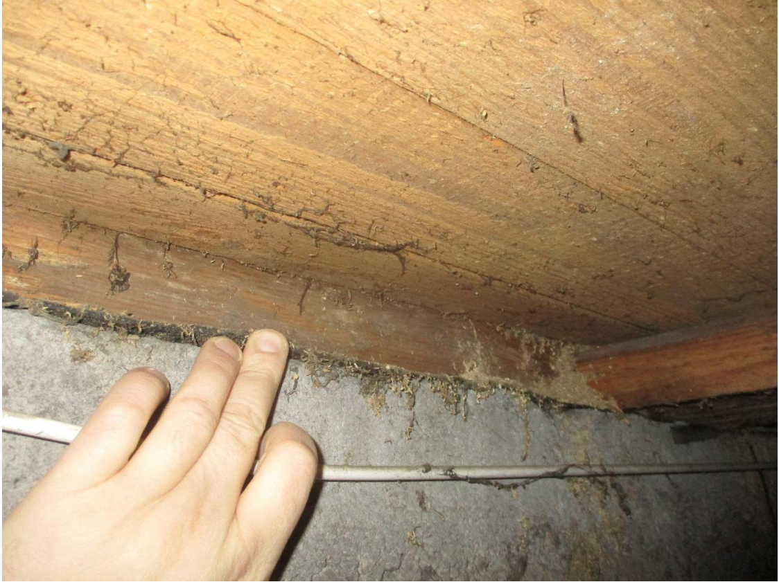
Kuva 41 Perusmuurin ja alajuoksun välissä on bitumikermiä kapillaarikatkona. Kapillaarikatkon puuttuminen ei ole tavatonta.
