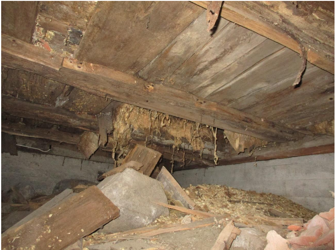
Kuva 52 Täysin tuulettumaton ryömintätila on mahdollistanut lahovaurion synnyn.
