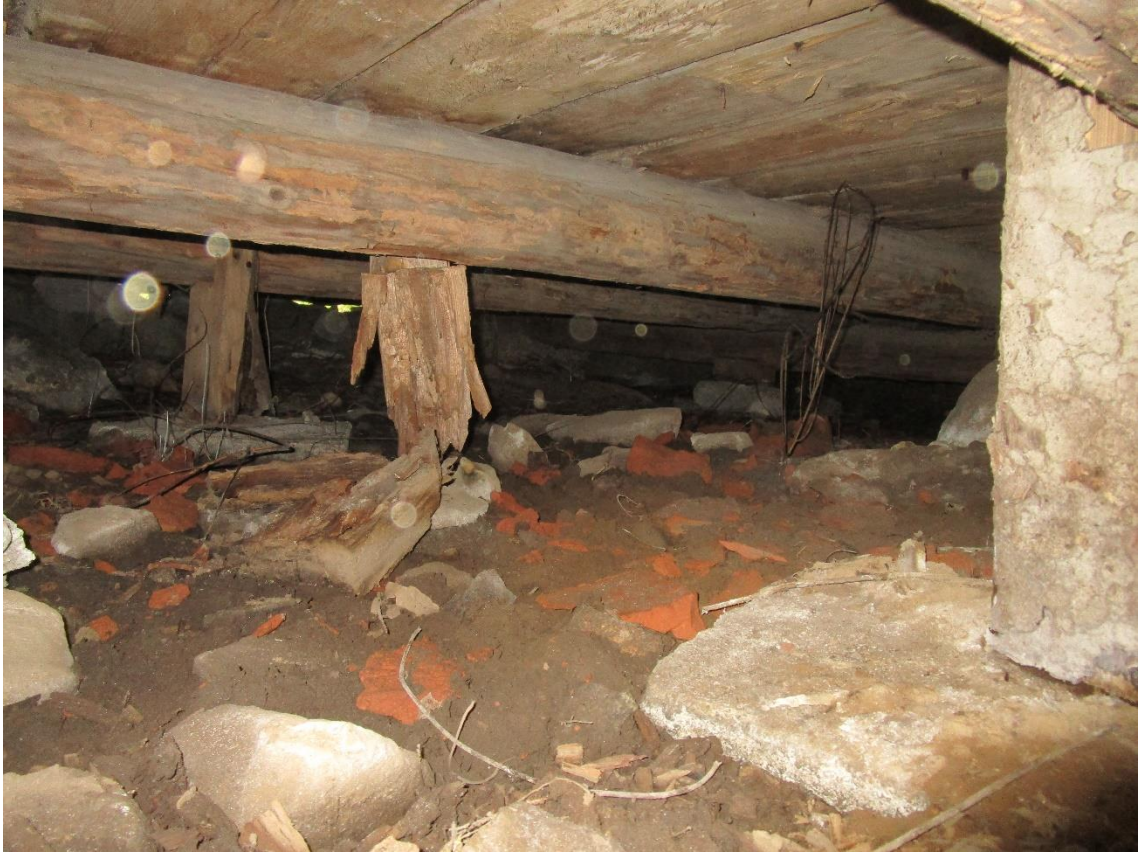
Kuva 33 Virheellinen maanpinnan kallistus ohjaa vettä ryömintätilaan, josta on seurannut alapohjarakenteiden vaurioitumista.
