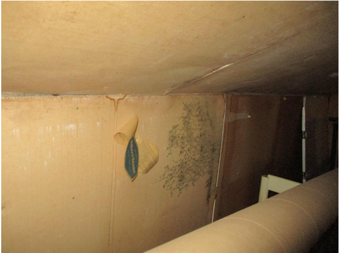
Kuva 61 Rakenteissa kulkeva kondenssikosteus näkyy toisinaan yläkerrassa kohdassa, jossa eristetty vinosuuntainen kattolape liittyy sivuvinttejä rajaaviin väliseiniin.
