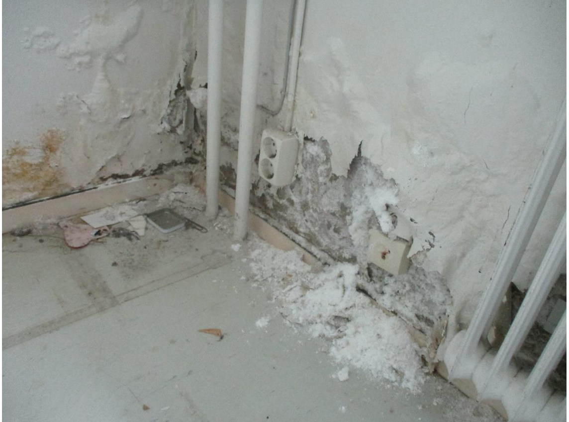
Kuva 43 Poikkeuksellisen voimakasta kosteutta kellarin seinän alaosassa. Tiiviillä maalilla maalatun rappauksen pinta kupruilee sekä irtoaa ja perusmuurin kiviaineksen sisältämiä suoloja eli kalkkihärmää tulee esiin.
