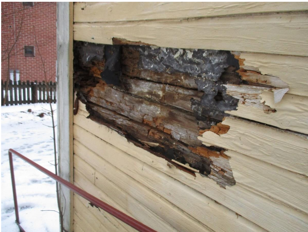
Kuva 24 Tuuletusraottoman ulkovuoren tiivis maalipinta on aiheuttanut ulkovuoren lisäksi lahovaurioita myös seinärunkoon.
