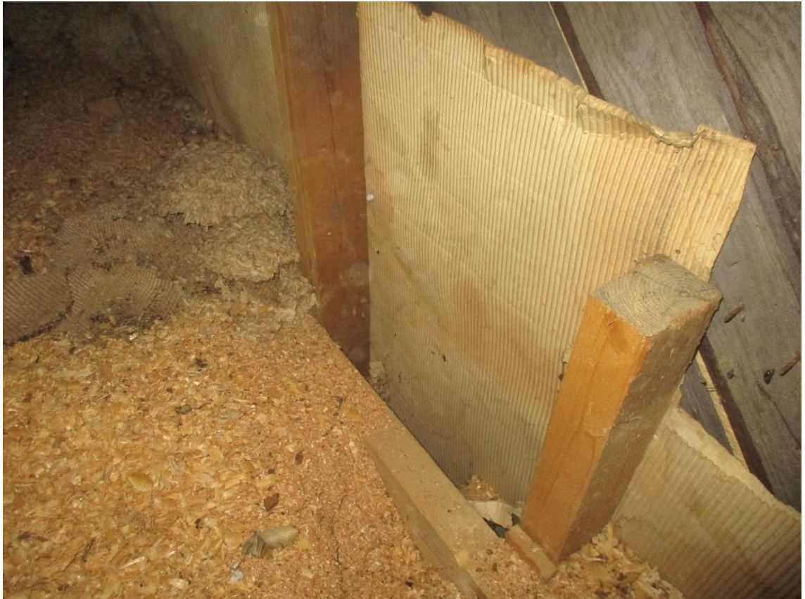
Kuva 55 Lämmöneristeiden tiivistyminen muodostaa tyhjiä kohtia seinien yläosiin.
