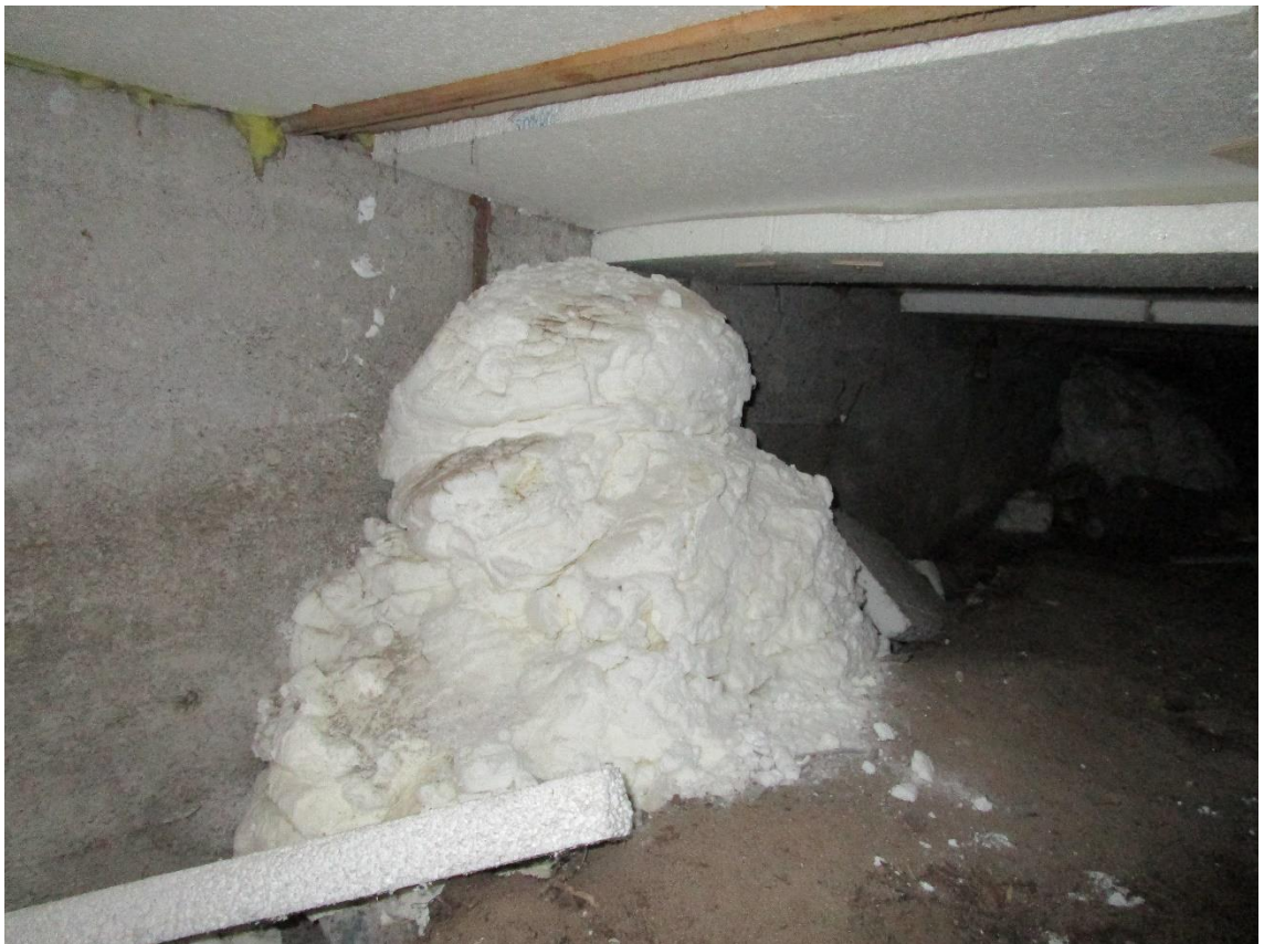
Kuva 11 Lattiarakenteeseen puhallettu ureavaahto on kulkeutunut asennusvaiheessa lattian epätiiväisyys- eli ilmavuotokohdan kautta röyrintätilaan.
