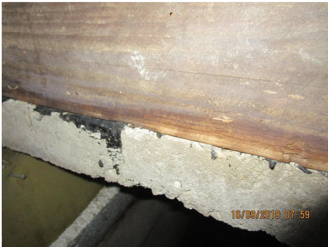
Kuva 27 Toisinaan kellariin johtavan portaikon kohdalta on nähtävissä betoniholvia. Tässä kohteessa betoniholvin yläpinnassa on kreosoottipitoinen pikisively.
