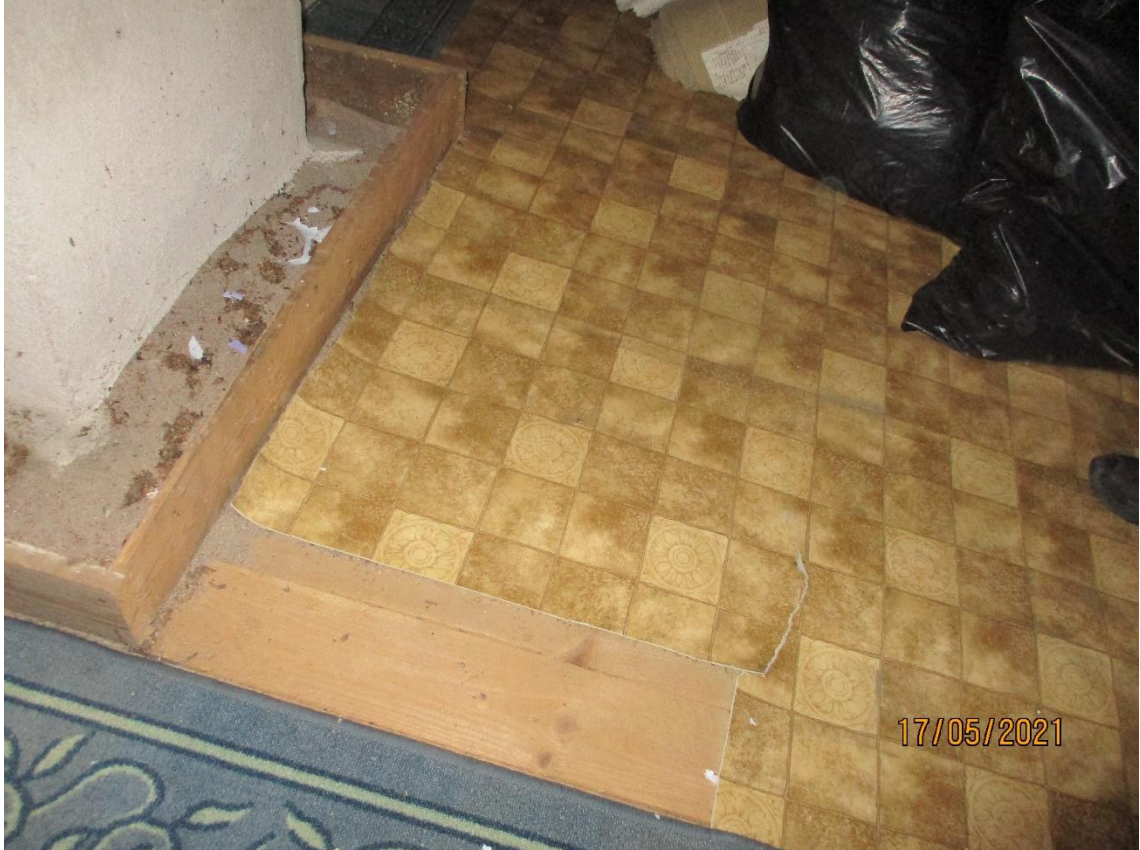
Kuva 48 Lämmittämättömien vinttien lattioihin kierrätetyt muovimatot muodostavat höyrynsulkurakenteen rakenteen väärälle eli kylmälle puolelle.
