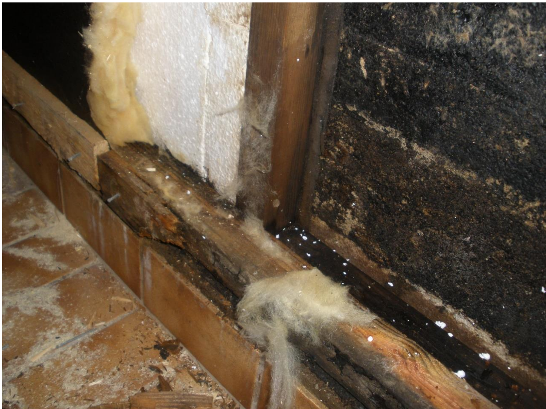
Kuva 20 Kellarin seiniin lisätyissä puisissa koolausrakenteissa ja lisälämmöneristeissä on tapahtunut voimakasta vaurioitumista. Lisäksi perusmuurin sisäpinnassa on kreosoottipitoinen pikisively.
