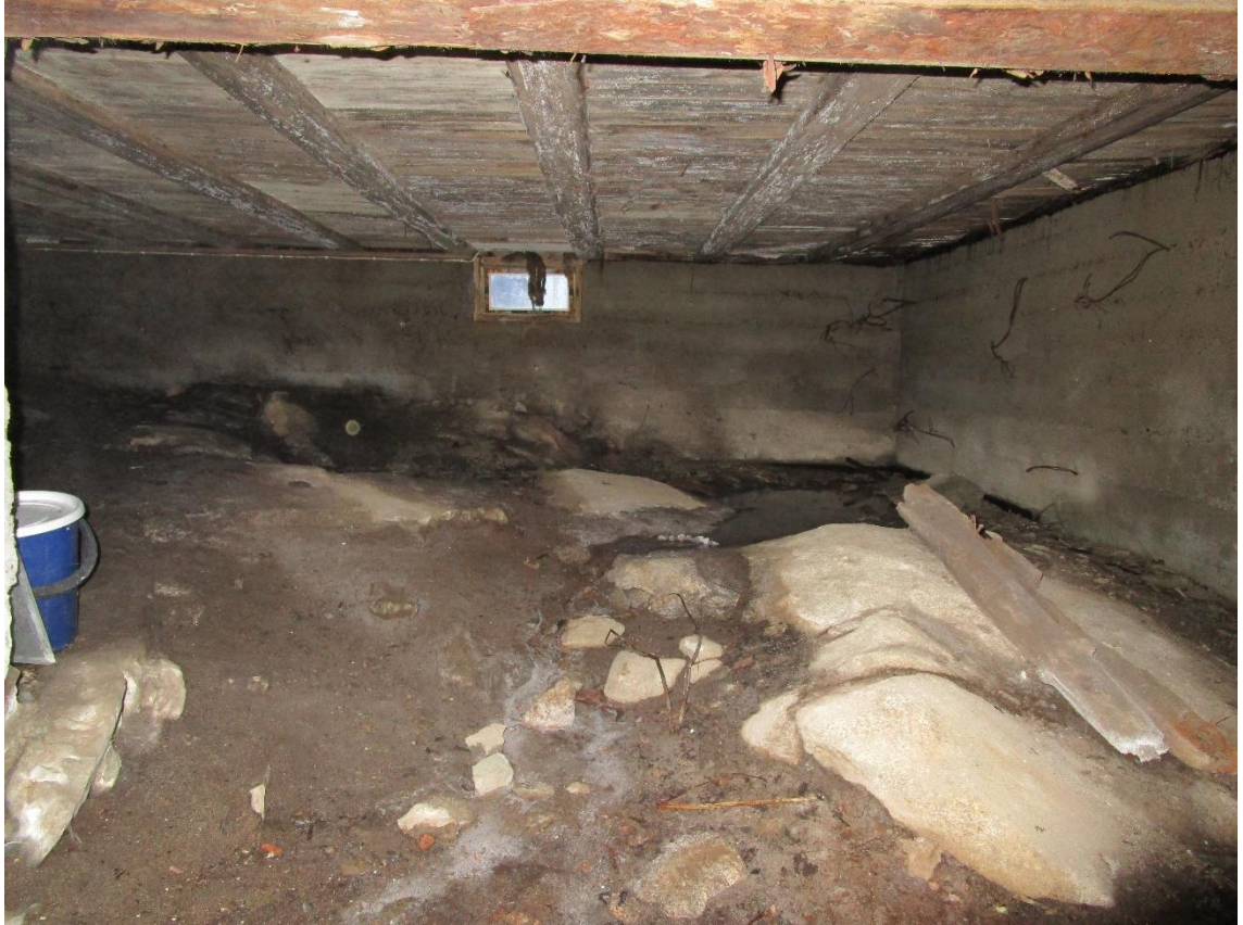
Kuva 29 Kallionpinnan muodot ohjaavat vettä ryömintätilaan, jonka lisäksi kallio jäähdyttää ryömintätilaa voimakkaasti. Tästä on seurannut alapohjarakenteen lahovaurioituminen.
