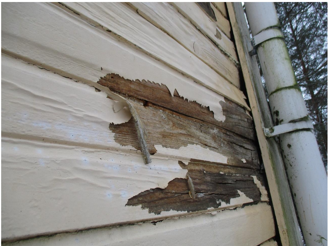
Kuva 3 Liian tiivis ulkomaali tuuletusraottoman ulkovuoren yhteydessä on aiheuttanut vaakasuuntaisten keilaponttipaneelien lahovaurioitumisen.
