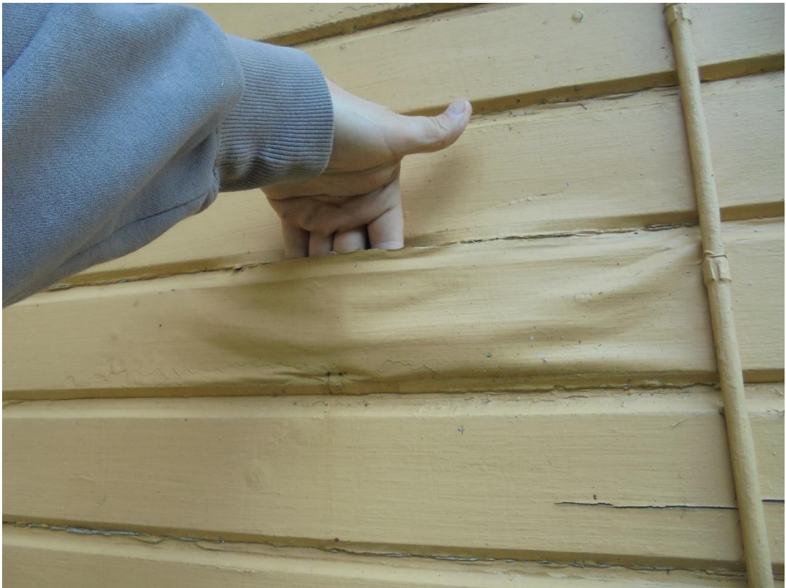
Kuva 23 Liian tiivis maalikalvo ja puuttuva tuuletusrako ovat aiheuttaneet ulkovuoren ja seinärungon vaurioitumista.
