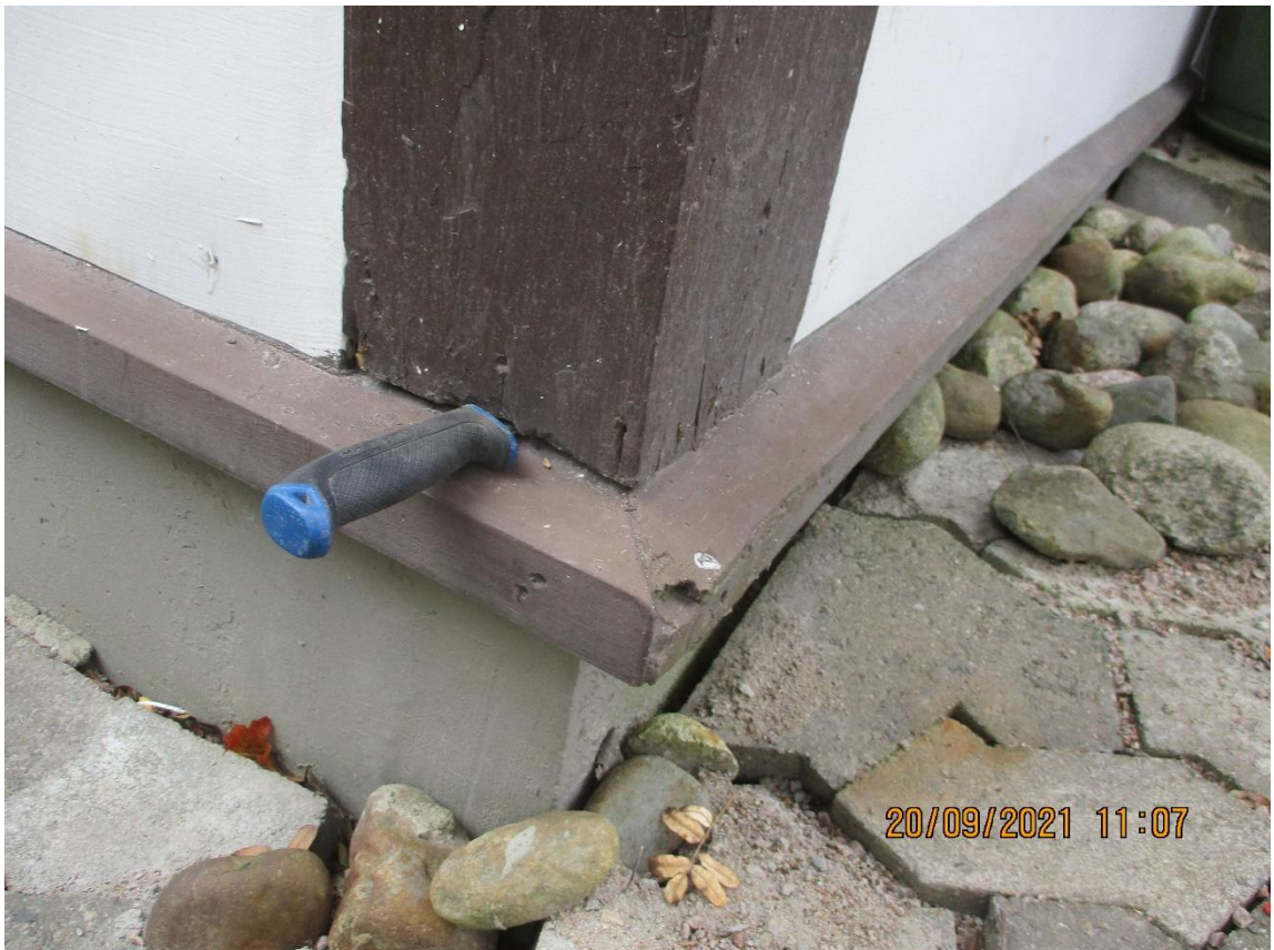
Kuva 19 Kapillaarikatkon puuttuminen on aiheuttanut lahovaurion alajuoksuun.
