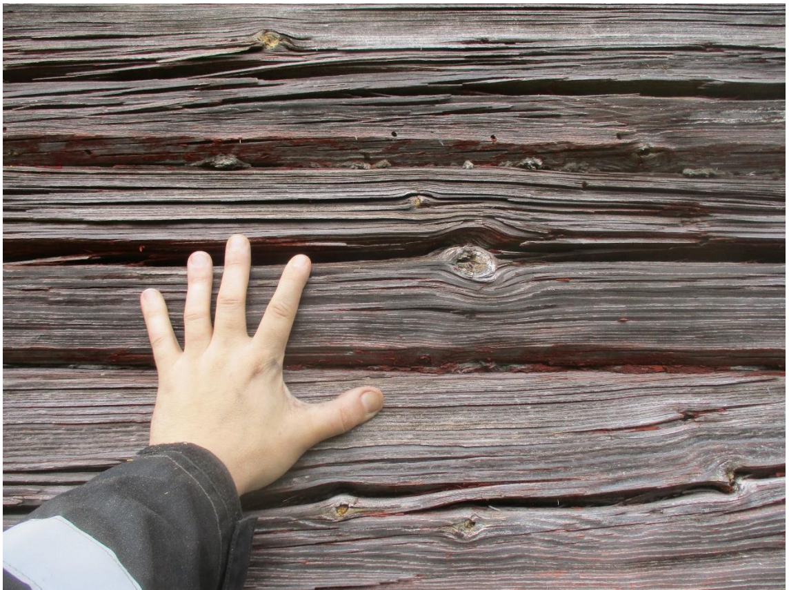
Kuva 22 Suojaamaton hirsirunko kestää paremmin vettä kuin auringon UV-säteilyä. Auringon UV-säteily aiheuttaa hirsien pintojen säilytymistä eli halkeilua.
