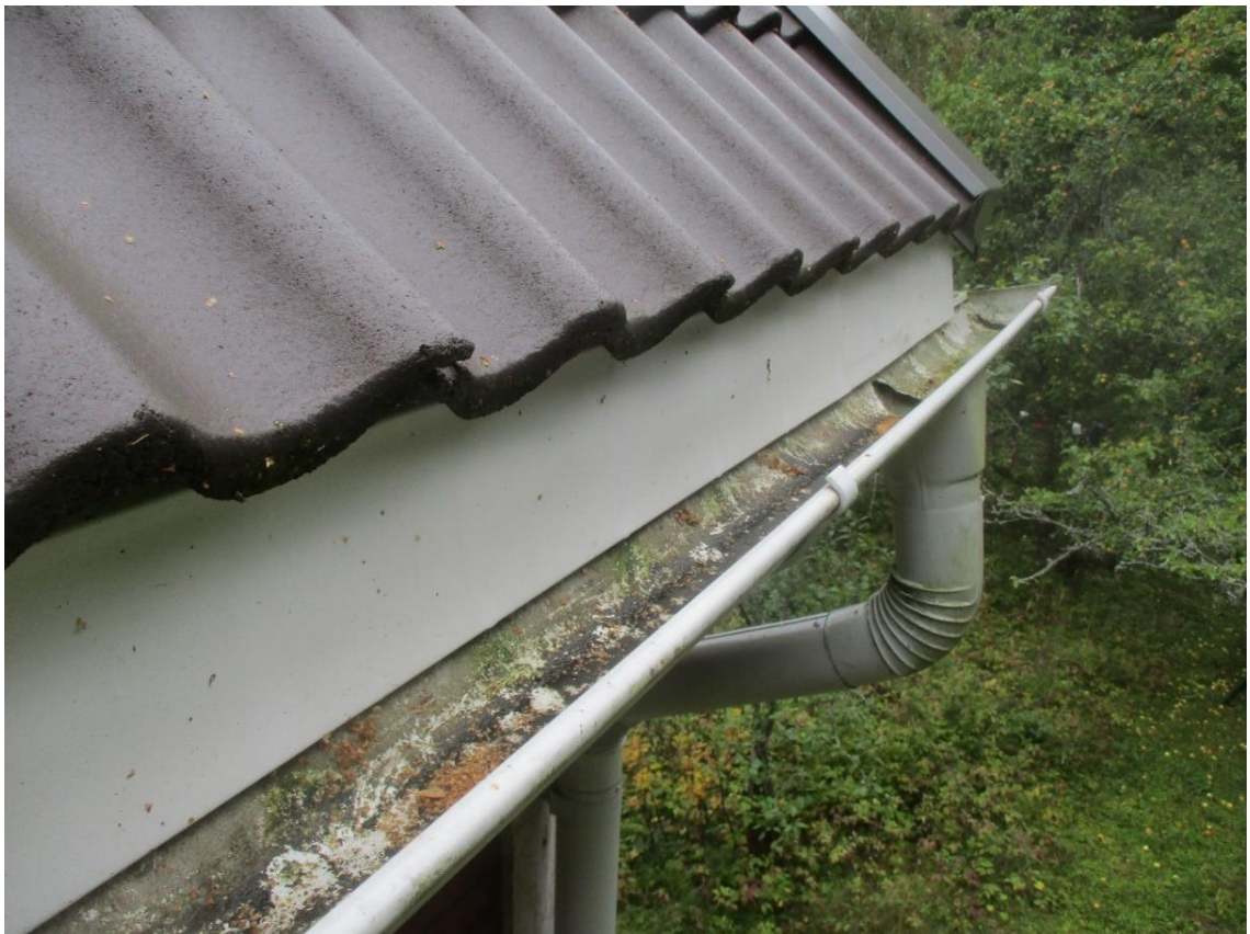
Kuva 37 Sadevesikouru on liian alhaalla suhteessa vesikatteeseen, jolloin vesi lentää kovalla sateella kourun reunan ylitse.
