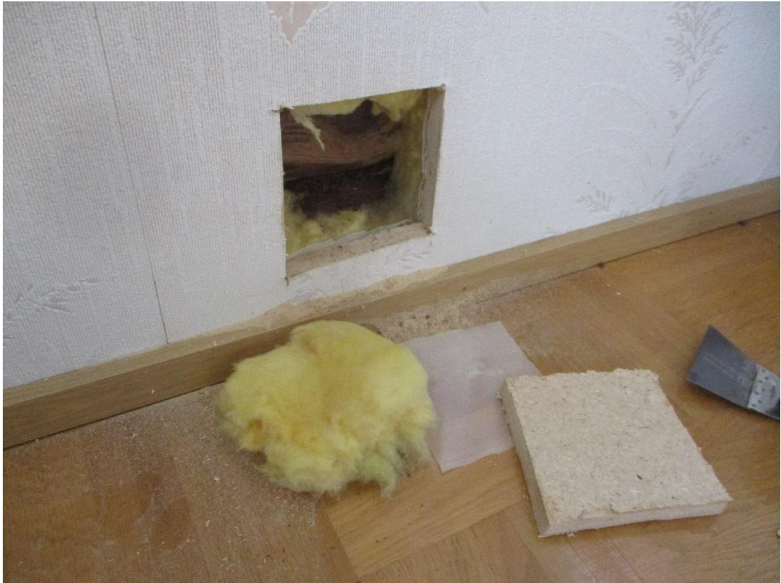
Kuva 58 Maltillisen paksuinen sisäpuolinen lisälämmöneristys ei aiheuta seinärakenteen vaurioitumista.
