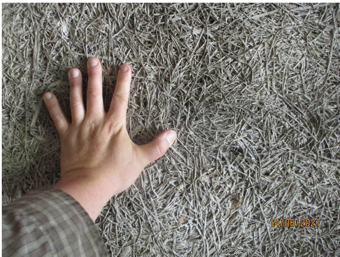
Kuva 21 Rappaamatonta Toja-levyä kellarin seinässä.
