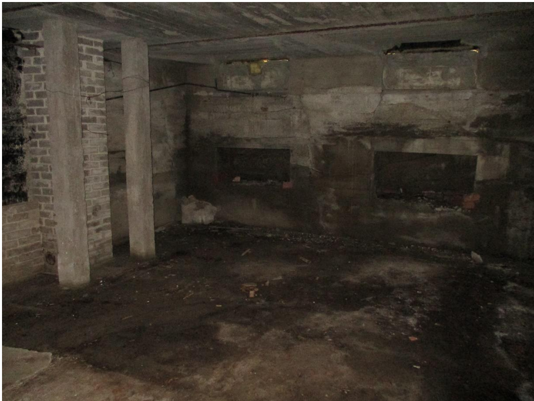
Kuva 42 Betonipinnalla olevassa kellarissa ei ole varsinaisesti mitään kosteudesta vaurioituvaa, mutta kellarin kosteus vaikuttaa betoniholvin päällä olevaan lattiarakenteeseen. Kellari on saatava kuivemmaksi ja lattiarakenne on kunnostettava.
