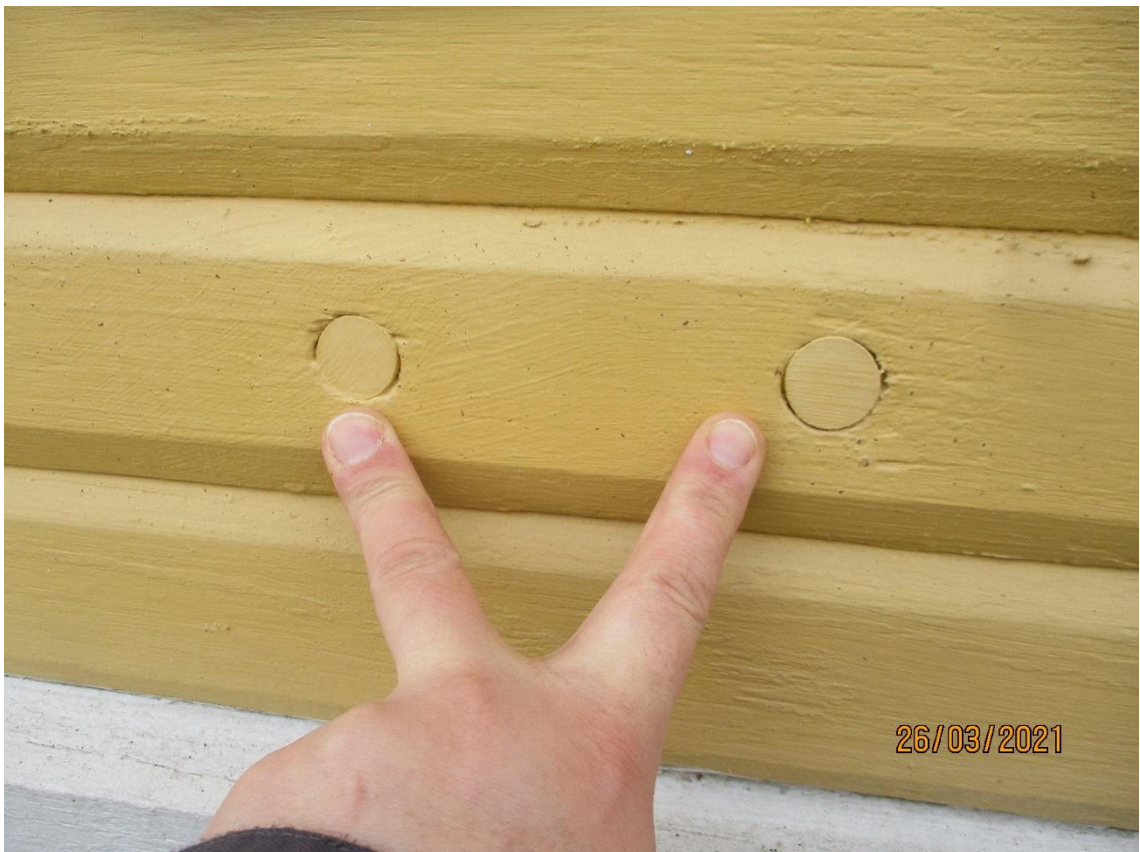
Kuva 10 Ureavaahdon tulpattuja asennusreiäitä. Vaikka asennusreiät ovatkin seinissä, on ureavaahdon asennuspaikka seinärakenteen sijaan lattia.
