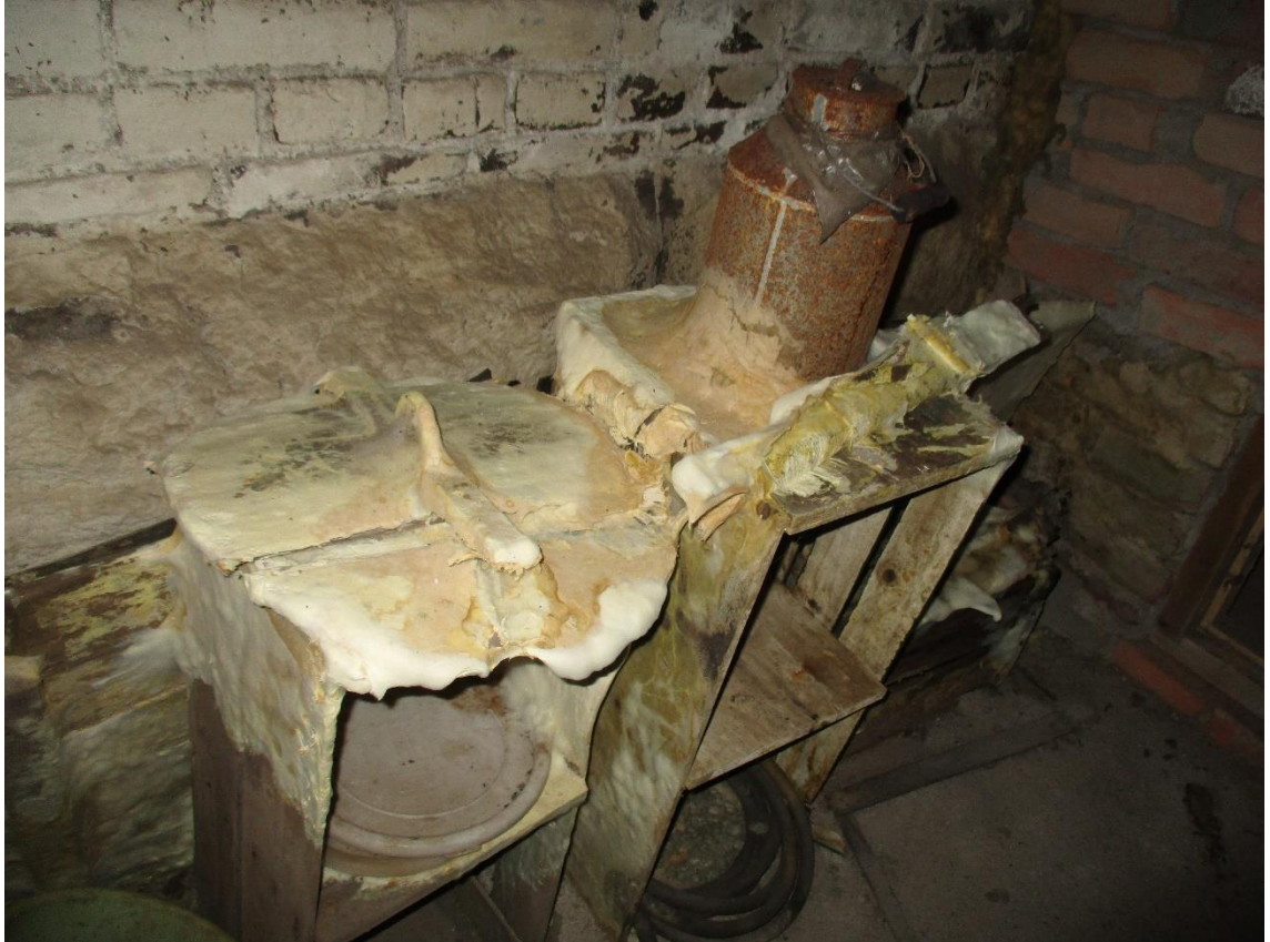
Kuva 46 Lahottajasienikasvusto on vallannut kosteassa kellarissa olevat puiset hyllyt.
